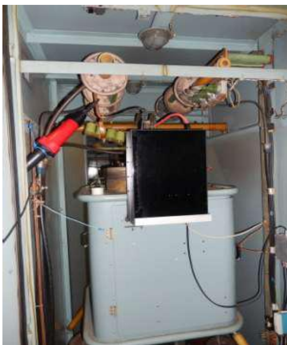
Рис. 2.2.29. Твердотельный ключ со схемой защиты, установленный в ячейке модулятора генератора «Родонит»
